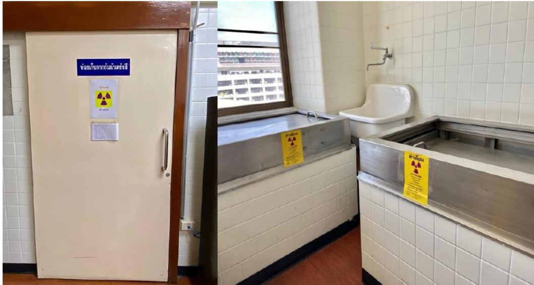
ภาพที่ 1 ห้องเก็บกากกัมมันตรังสี แสดงบ่อพักกากรังสี แยกตามค่าครึ่งชีวิตของสารกัมมันตรังสี
